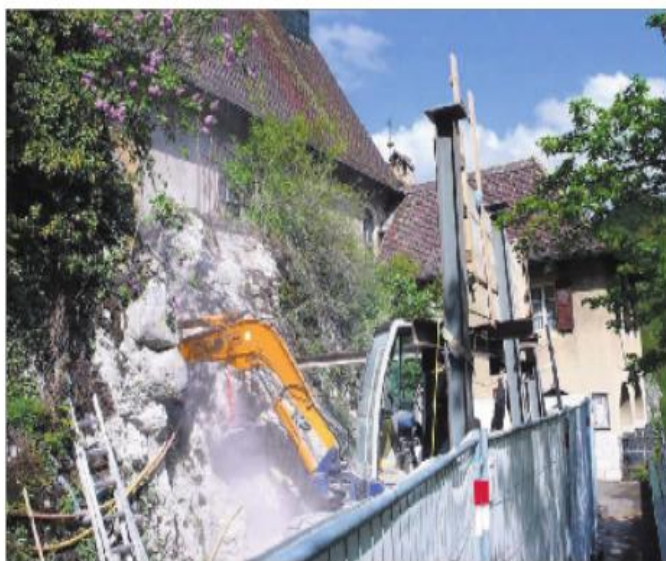
Les actuels travaux d'aménagement de l'ascenseur n'interdisent en rien l'accès à la chapelle du Vorbourg.
